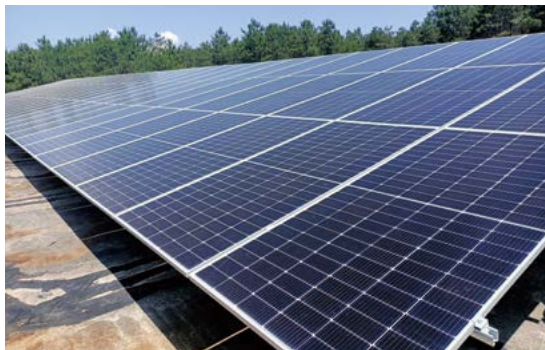
临武县汾市镇寺冲村综合楼分布式光伏发电板
